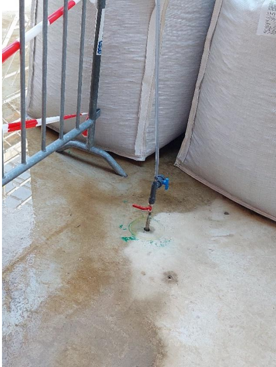
Foto 17 Afsluiter in de vloer
